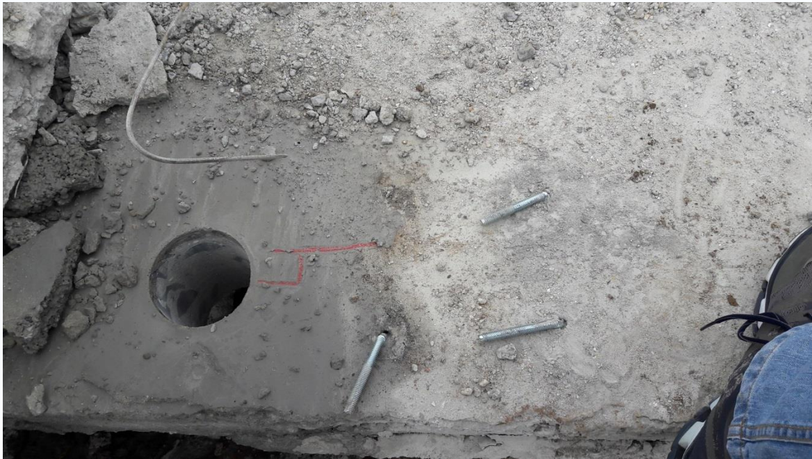
Local de viga onde foi possível extrair testemunho.
