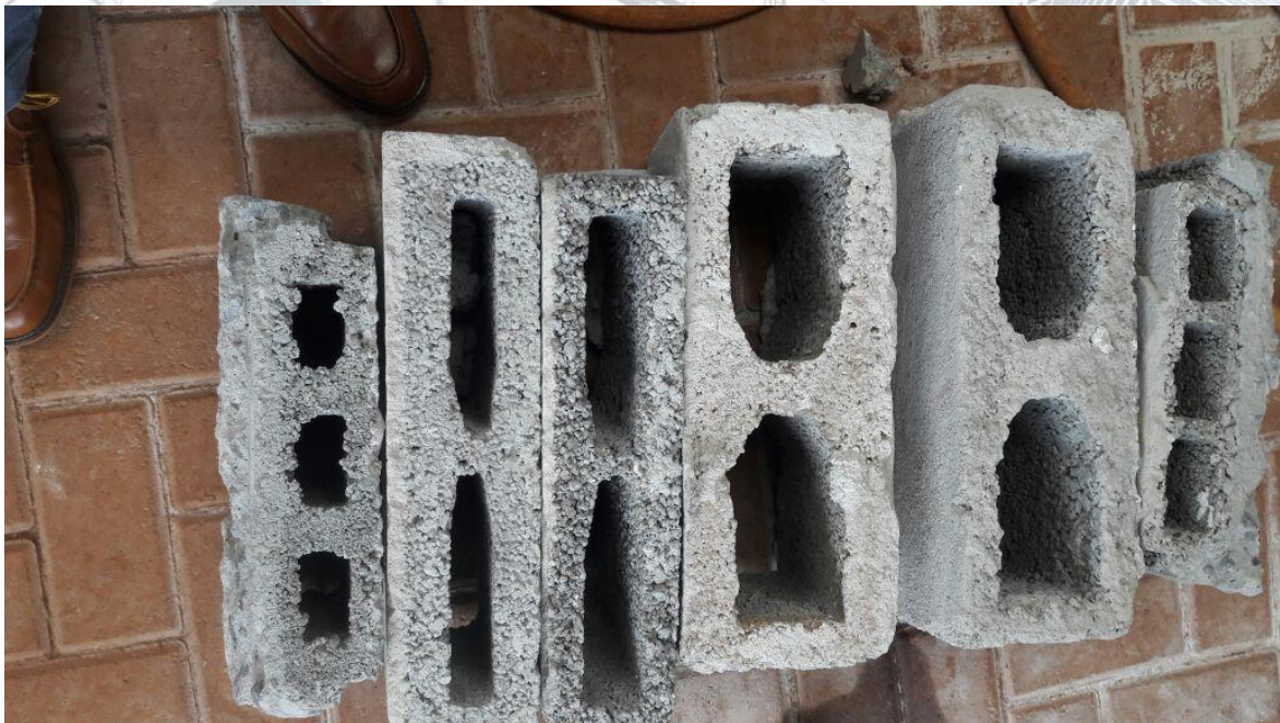
Blocos recolhidos da obra sinistrada.
